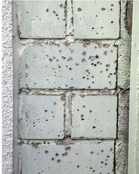
Bild 7: Fotografische Aufnahme von Frostschäden an einer Westwand aus Kalksandstein im Gelände der Freilandversuchsstelle Holzkirchen des IBP nach dem Winter 1998/99.
